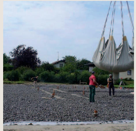
Solespeicher für Wärmepumpe
